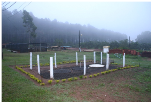
Figura 1. Fossa Séptica Biodigestora Instalada na ETEC Astor de Mattos
